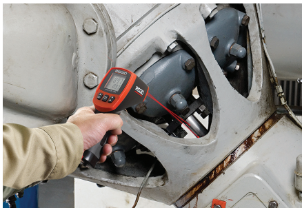
プラント予防保守のため磨耗部品の温度を診断します。
